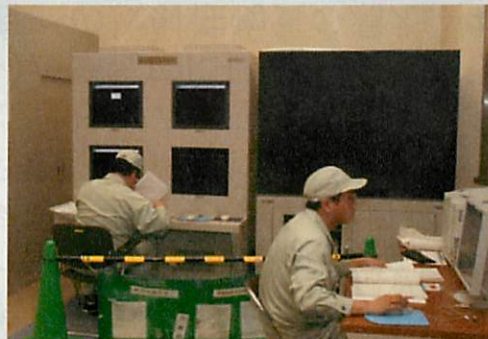
〔総合漏えい監視システムの追加設置〕
