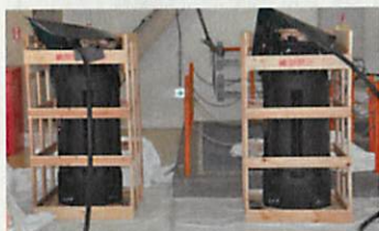
代替ポンプ(水中ポンプ2台)
