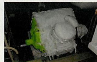
弁保温材のパッケージ化状況(緑部分)
